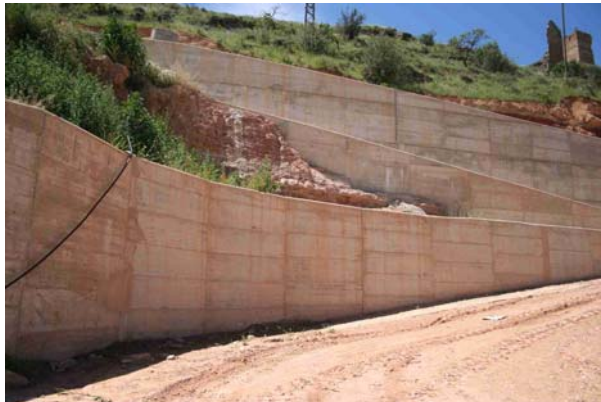
Foto. Estat actual dels talussos a la pujada del castell.
